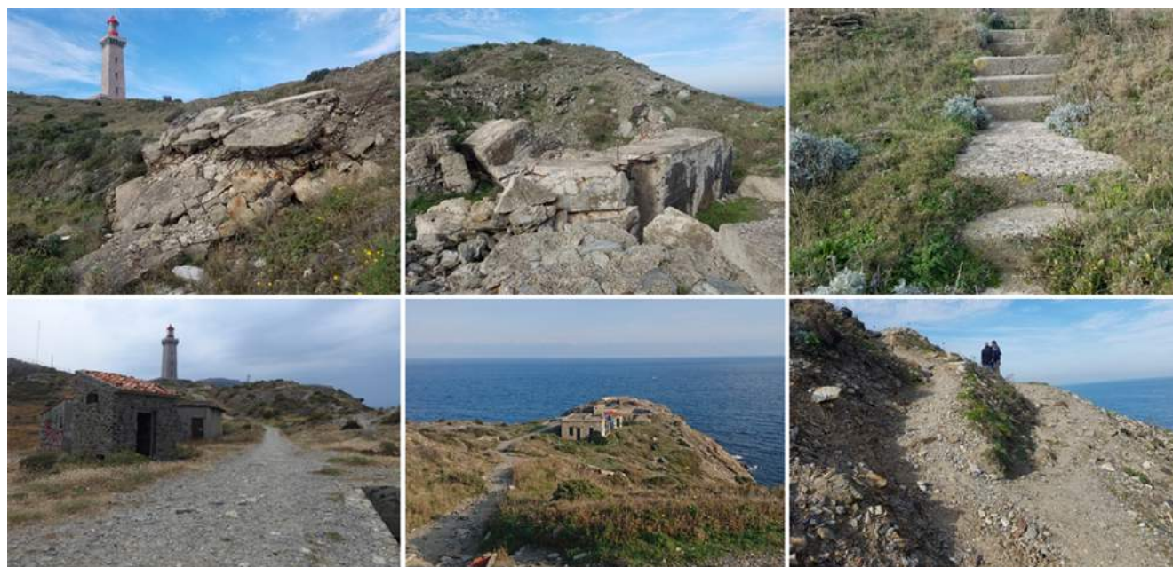
> Nature des ouvrages à démolir et des interventions sur le cheminement principal (exemples)
